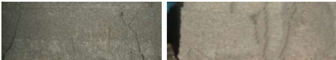
(a) Keretakan dari tepi ke tengah
